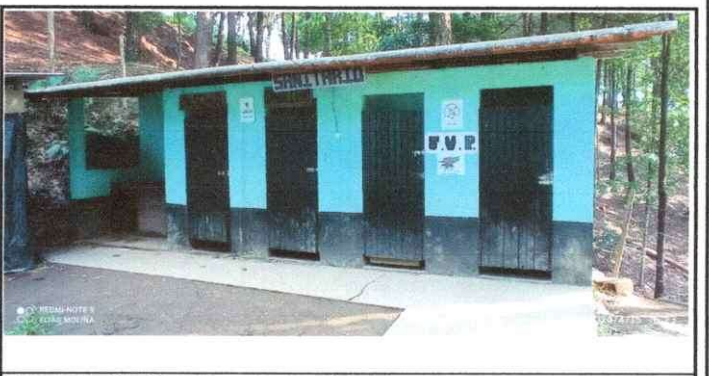
Foto 6: Sustrucción de puertas por deterioro
